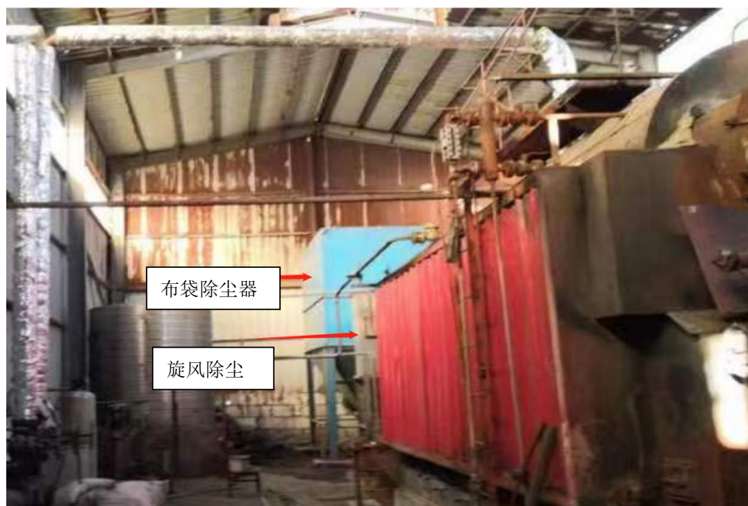
旋风除尘+布袋除尘器 (DA003锅炉废气)
