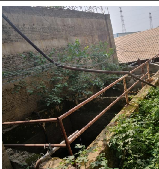
锅炉冷凝废水循环沉淀池
