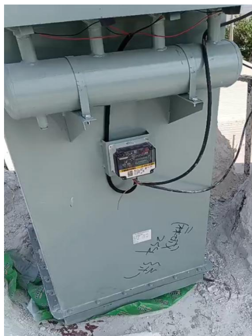
筒仓布袋除尘器
