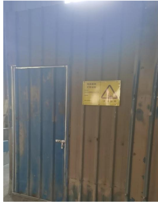
危险废物暂存间
