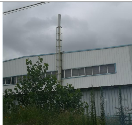
酸洗废气排气筒
