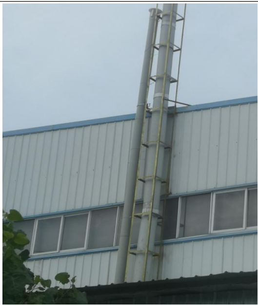
注塑废气排气筒
