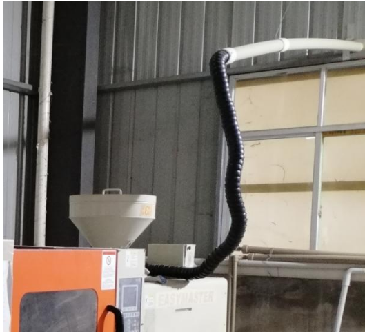
注塑废气管道
