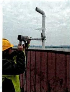
注液废气排气筒出口
