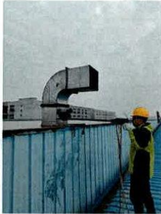
涂布烘干废气 排气筒出口
